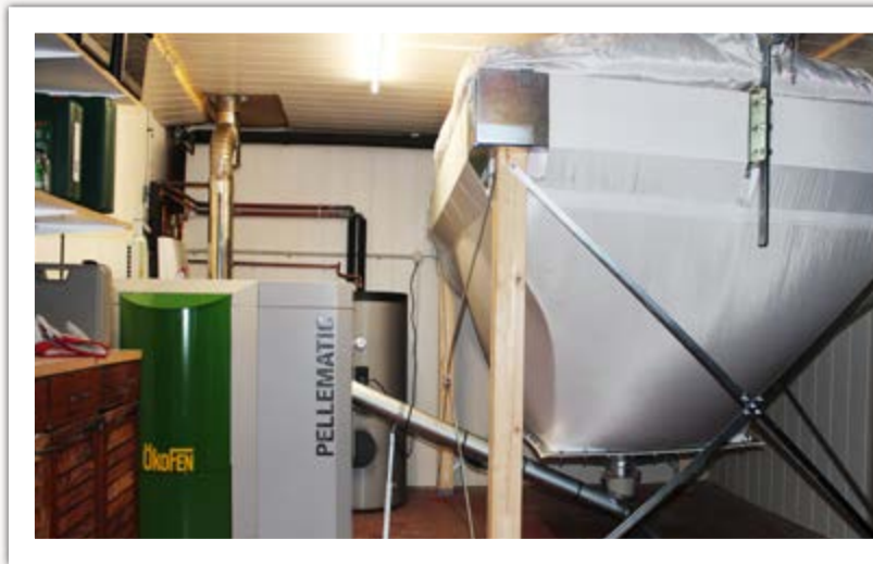
Chaudière à granulés de bois et silo d'approvisionnement - Source Effilogis
