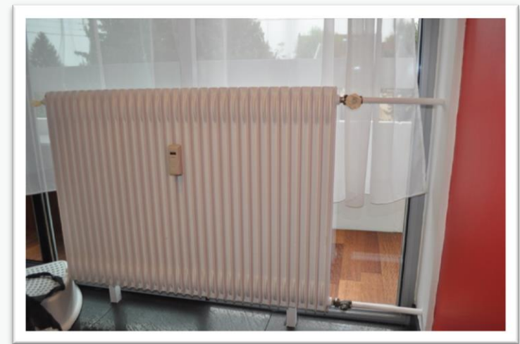
Radiateur à déplacer car rayonnant vers une paroi vitrée mal isolée, Source Ajena
