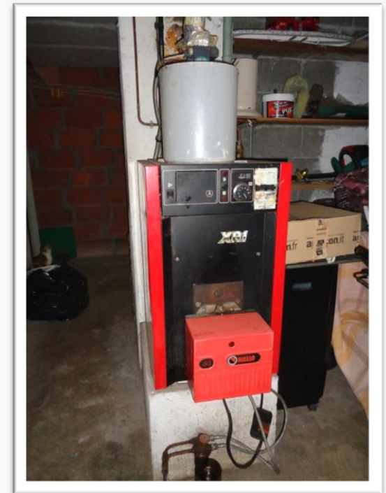
Chaudière ancienne, Source Ajena
