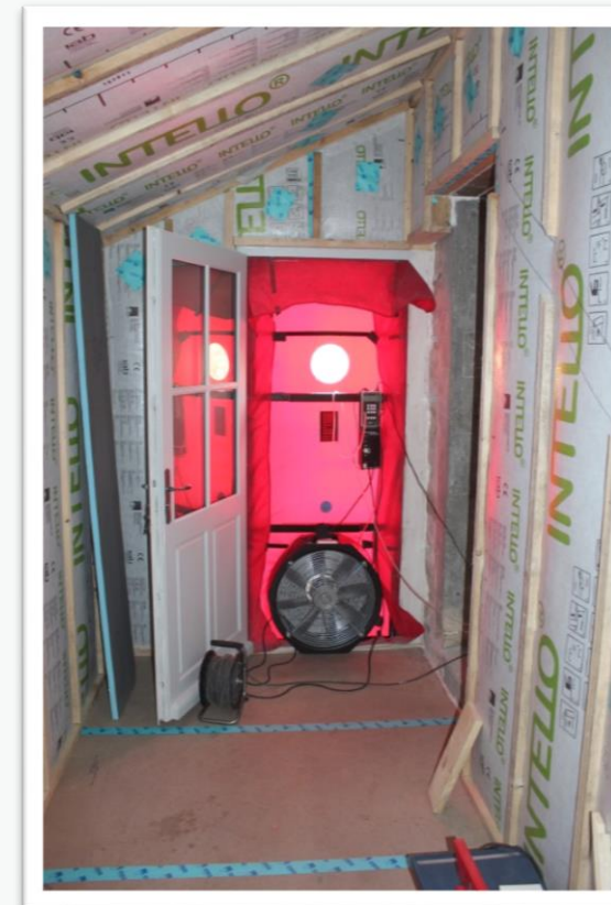
Test de perméabilité "intermédiaire" permettant de traiter les défauts avant la pose des parements intérieurs, Source Effilogis
