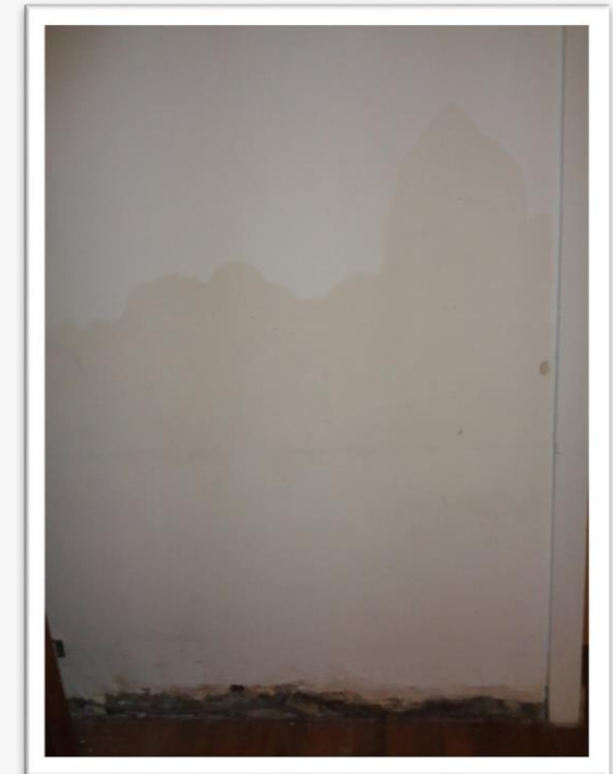
Signes de remontées capillaires : ne pas isoler un tel mur avant d'avoir identifié et traité les causes, Source Ajena
