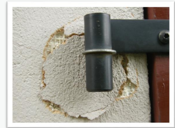
Arrachement de gonds de volets : fixations non conformes, Source Effilogis
